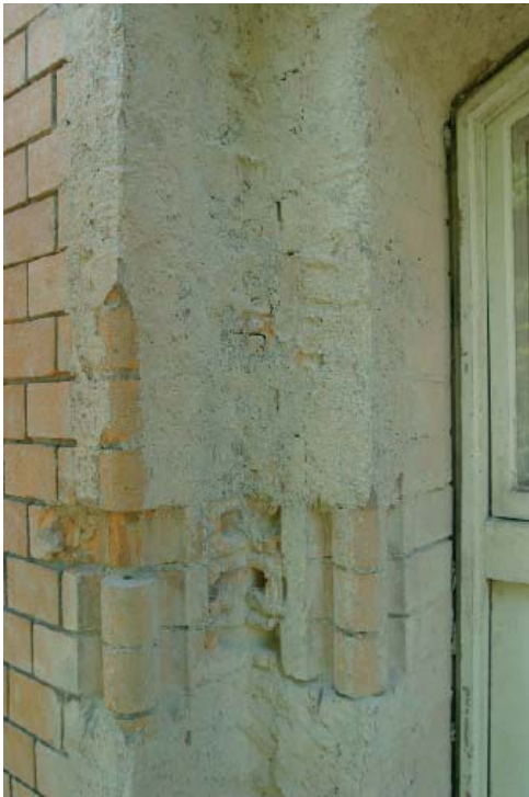
Beschädigte und überputzte Formsteingewände
